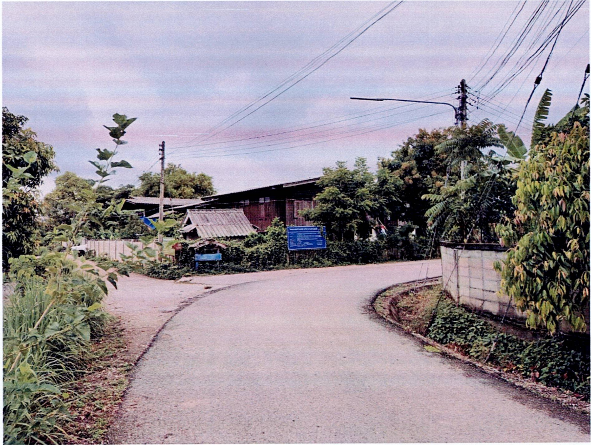
รูปภาพจุดเสี่ยงที่มีการติดตั้งไฟฟ้าสาธารณะรายทาง(ไฟกิ่ง)
